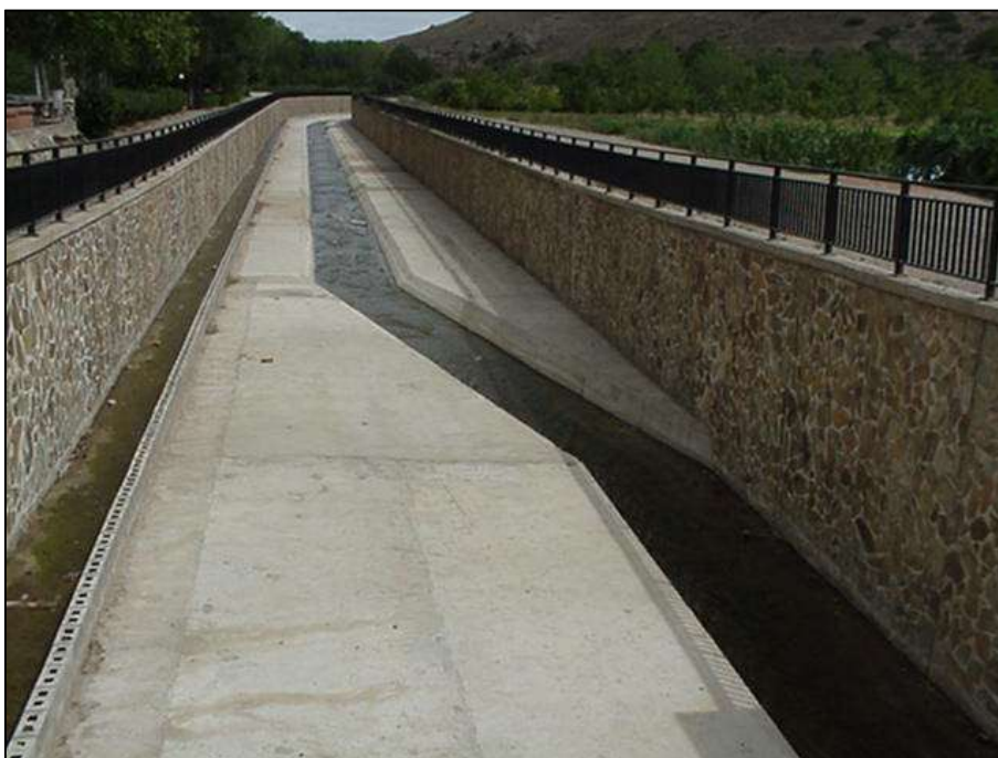
Ilustración 7. Fotografías de la estación de aforo del río Queiles en el municipio de Los Fayos (provincia de Zaragoza).
