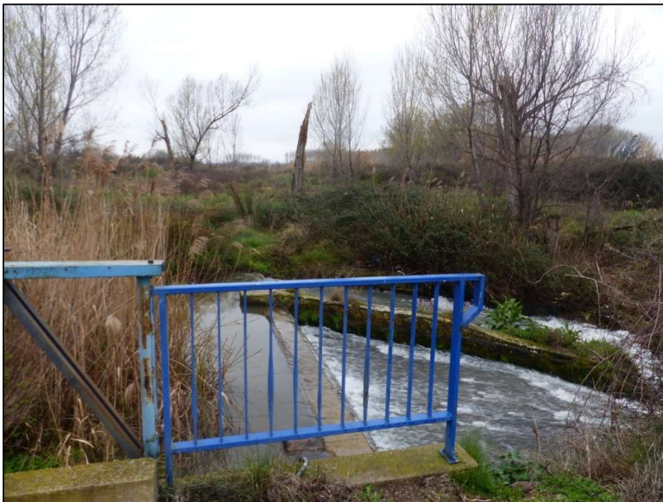
Ilustración 35. Sensores de nivel en el cauce del Queiles en Comunidades , en el término municipal de Malón.
