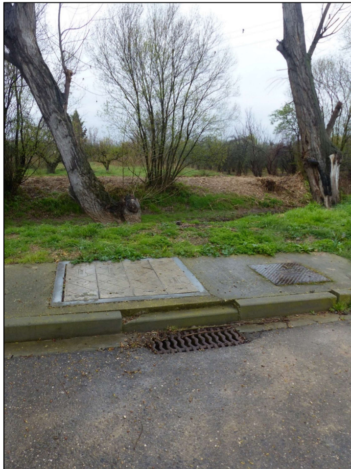
Ilustración 31. Zona del casco urbano, ya aguas abajo del puente de la carretera N-121-C. Viviendas de la calle Almoceda próximas al cauce del Queiles.
